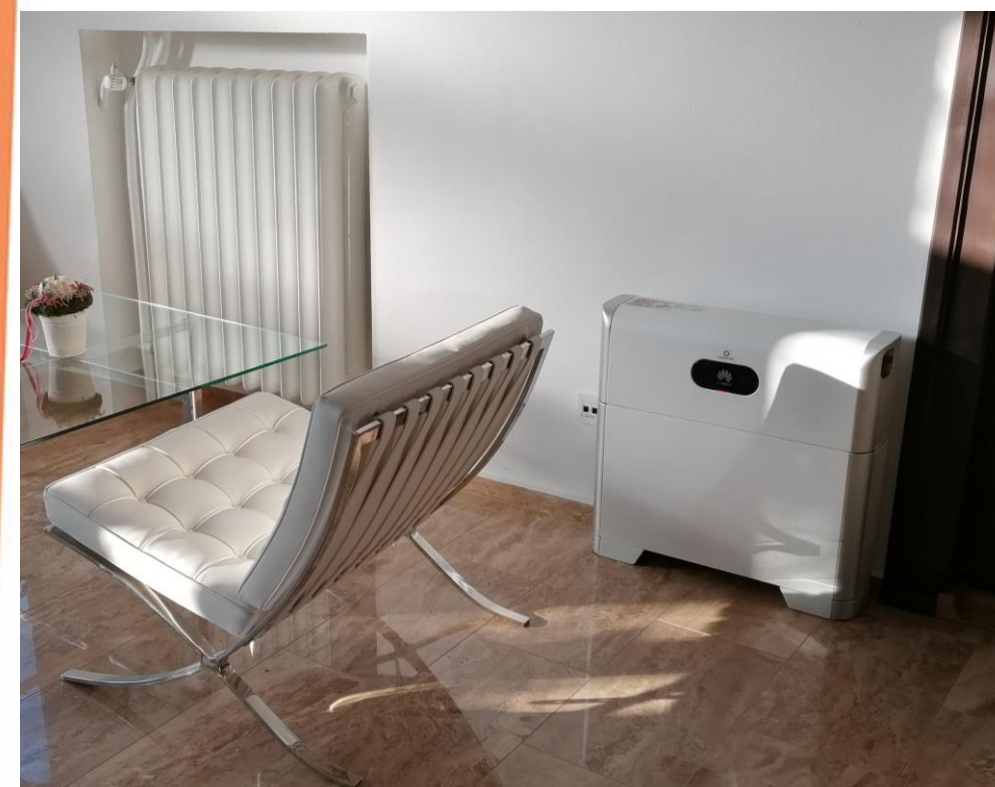
Rezidenční bateriová úložiště
