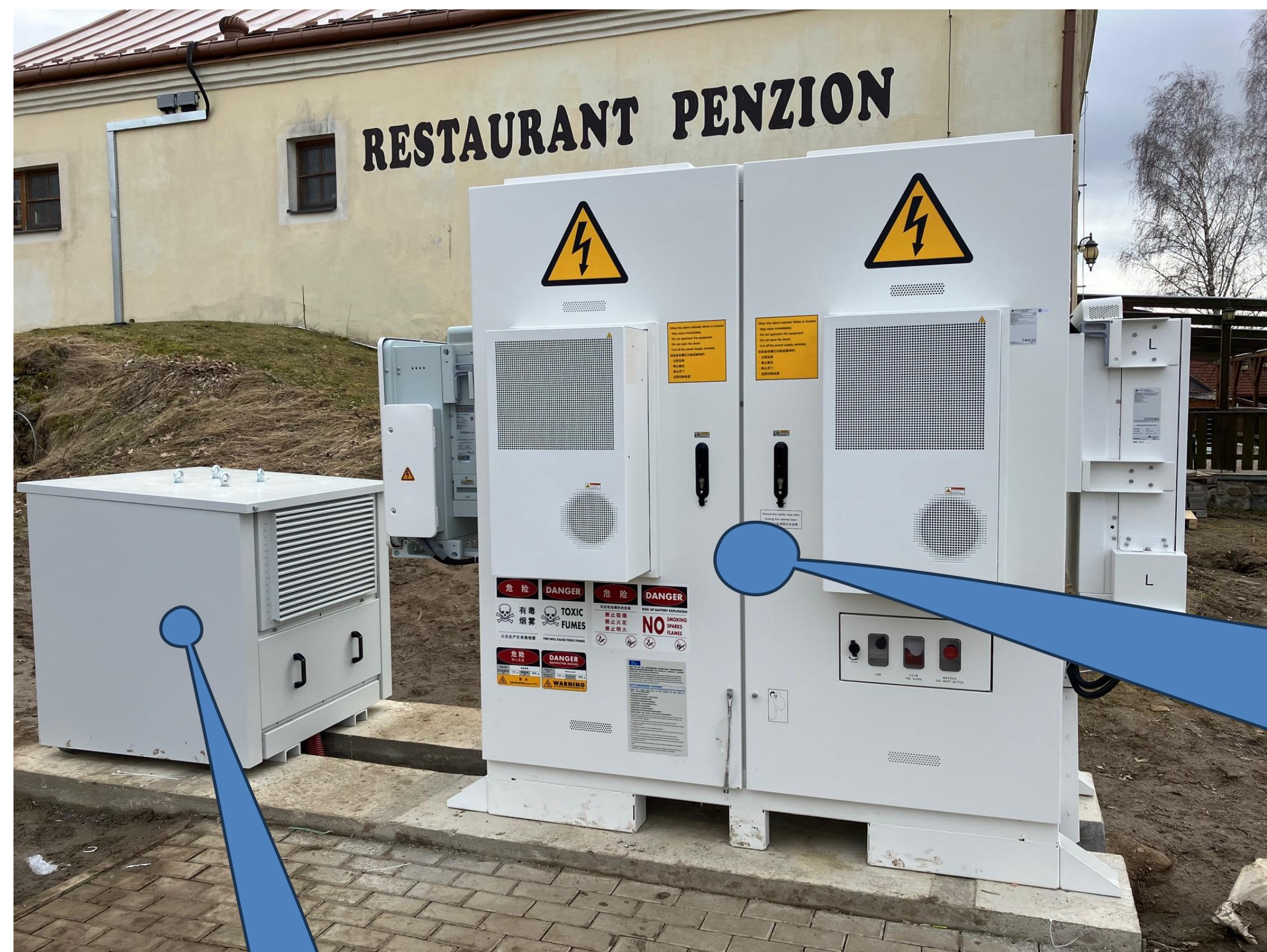
Bateriové úložiště LUNA2000-200KWH-2H1 100 kW/200 kWh
